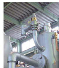
SD120のボイラー設置状況
